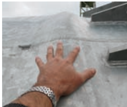
Detail vybúlenia po ukončení testov a demontáže
