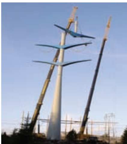
Extrémne vysoký zakružovaný stožiar koncepciou podobný pilonu veternej elektrárne
