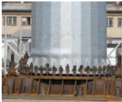
Typické symetrické vybúlenie drieku ohrňovaného stožiaru
