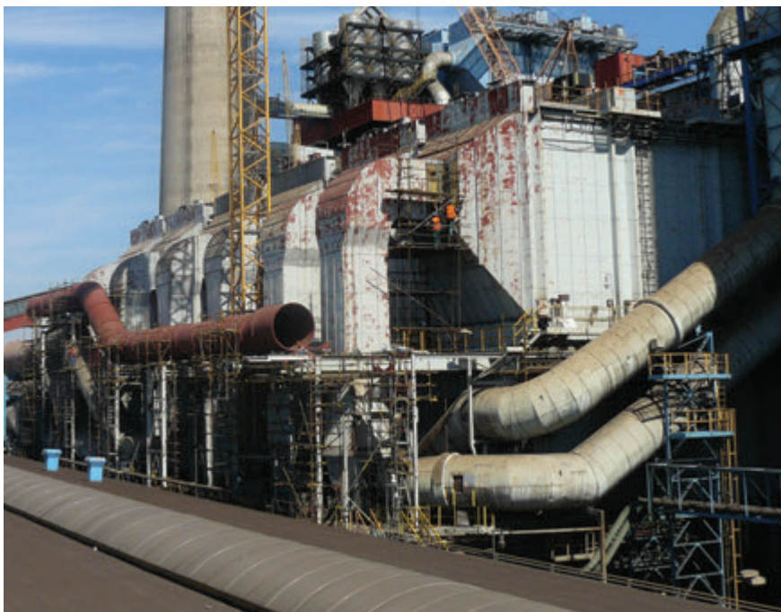
Stávající elektrostatické odlučovače kotlů
