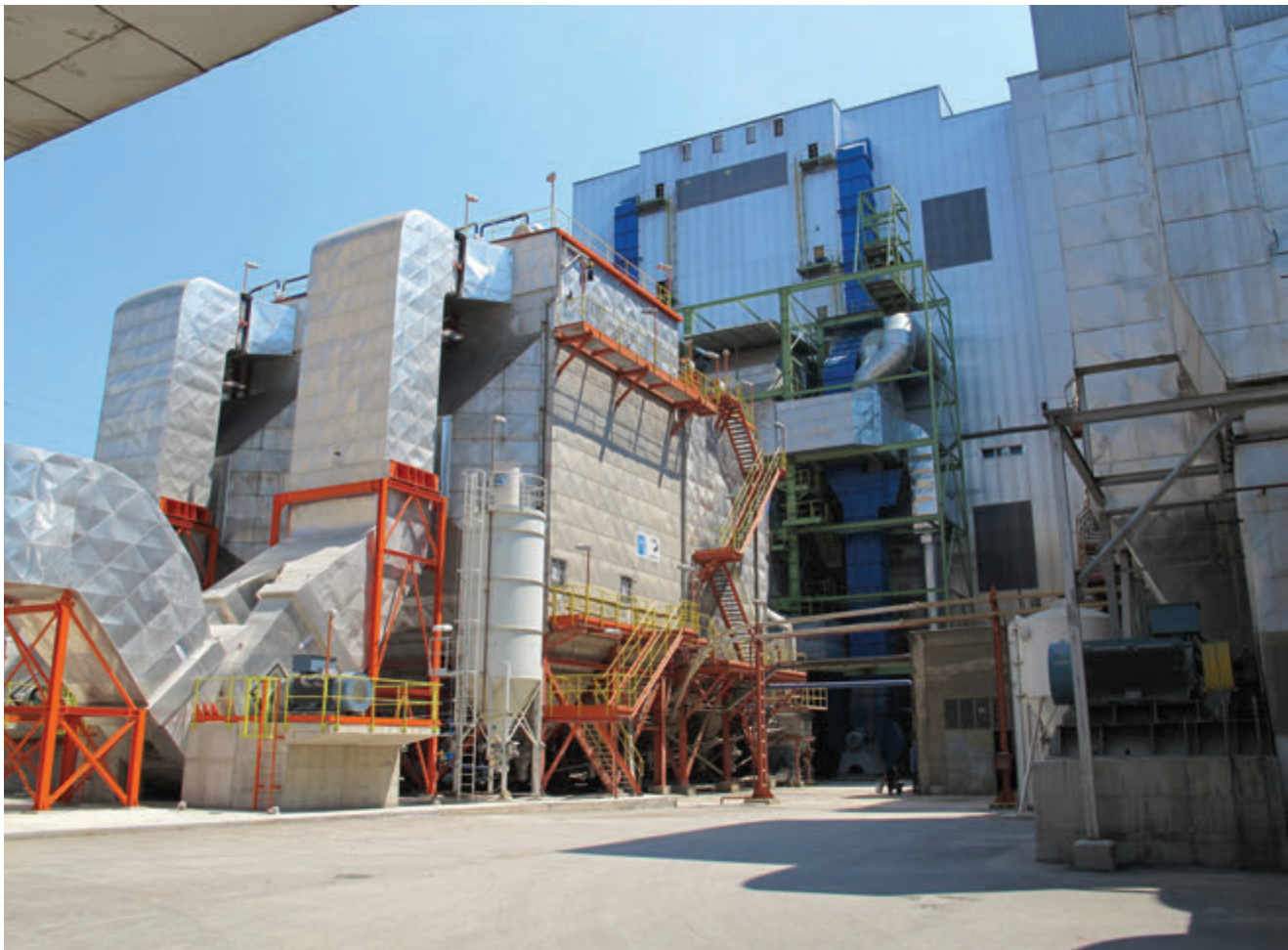
Kotelna bloku K6
