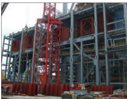
Budova vzduchotechniky slovinské elektrárny Sostanj
