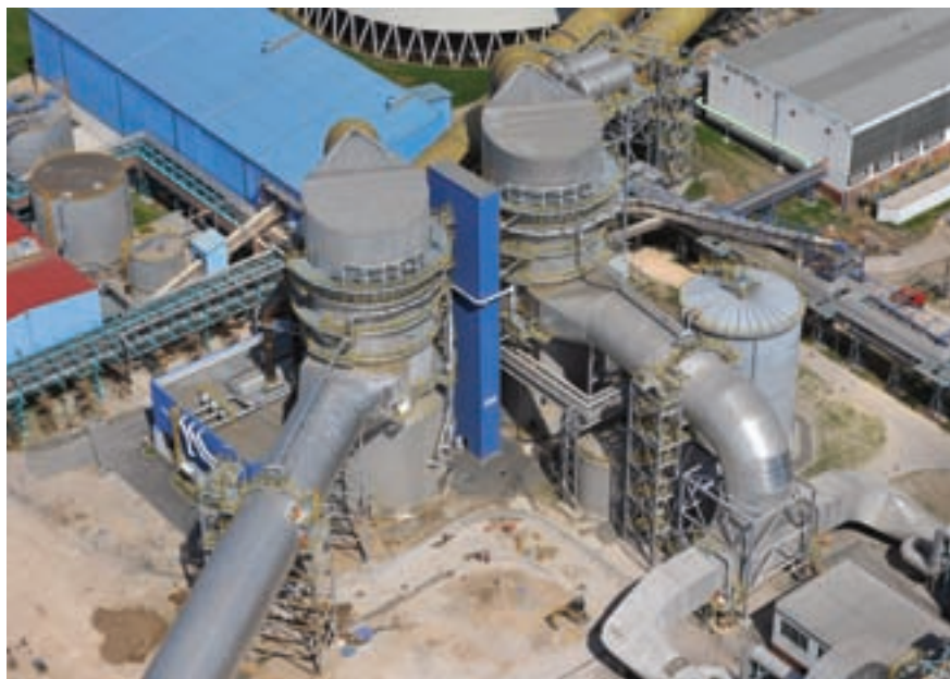
Pohled na technologická zařízení elektrárny
