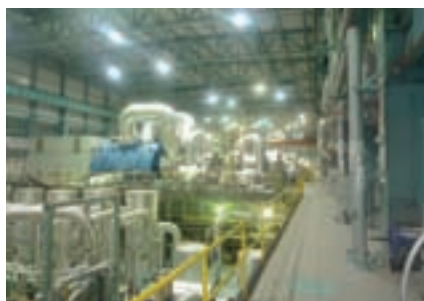
Stropní osvětlení - strojovna
