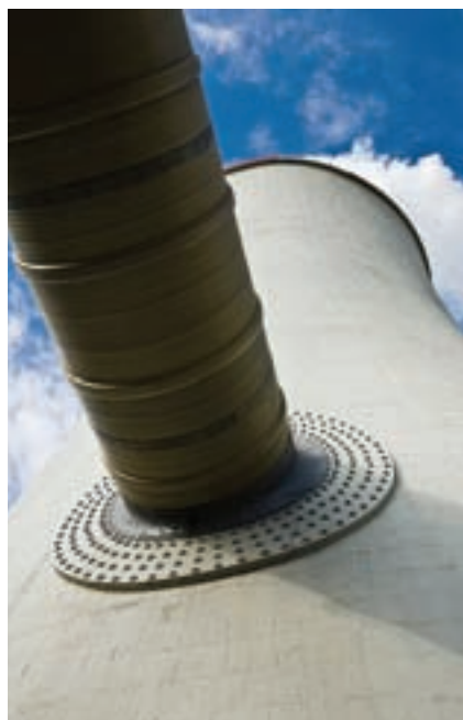
Prostup pro zaústění kouřovodu do chladicí věže
