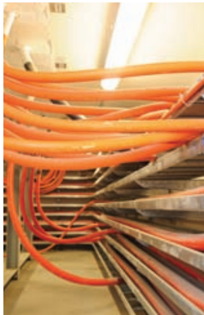
Kabelový prostor VN pod rozvodnami K1BBA a K1BBB na novém odsíření
