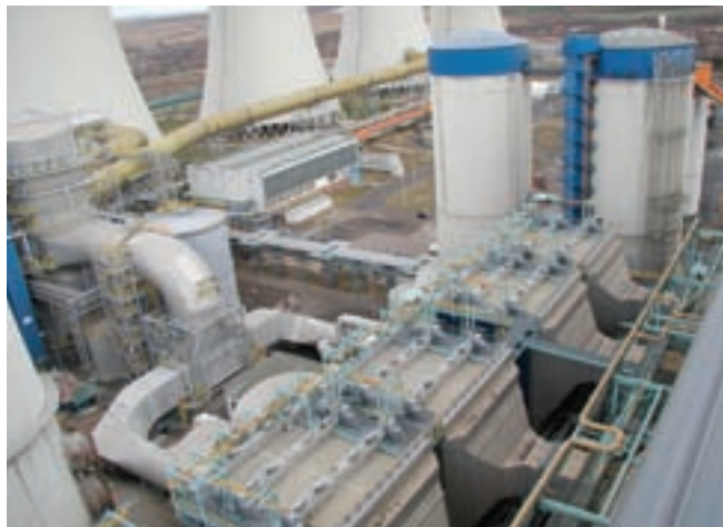
Provoz blok 23, 24 (odlučovače, spalínové ventilátory)
