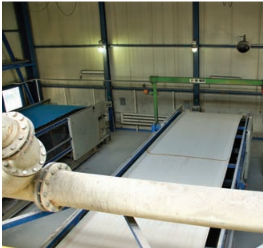
Dopravník na vápenec
