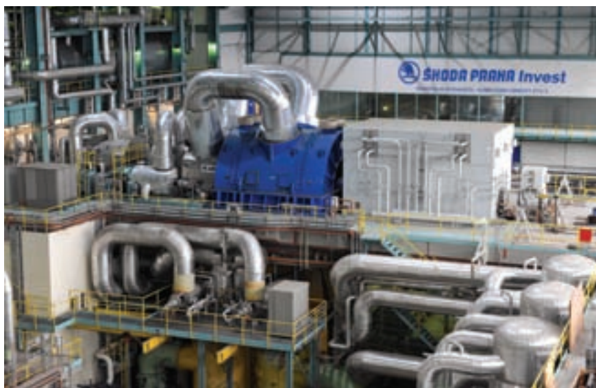
Strojovna hlavního výrobního bloku
