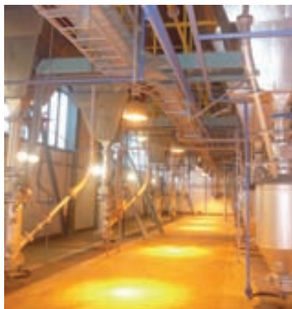
Kabelové trasy a osvětlení prostor výsypek elektro odlučovačů
