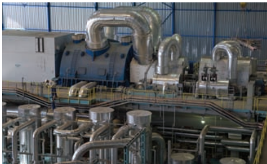
Strojovna bloku č. 23
