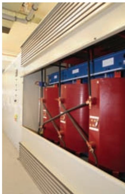
Transformátor Siemens v úsekové rozvodně K1BFA a K1BFB na novém odsíření
