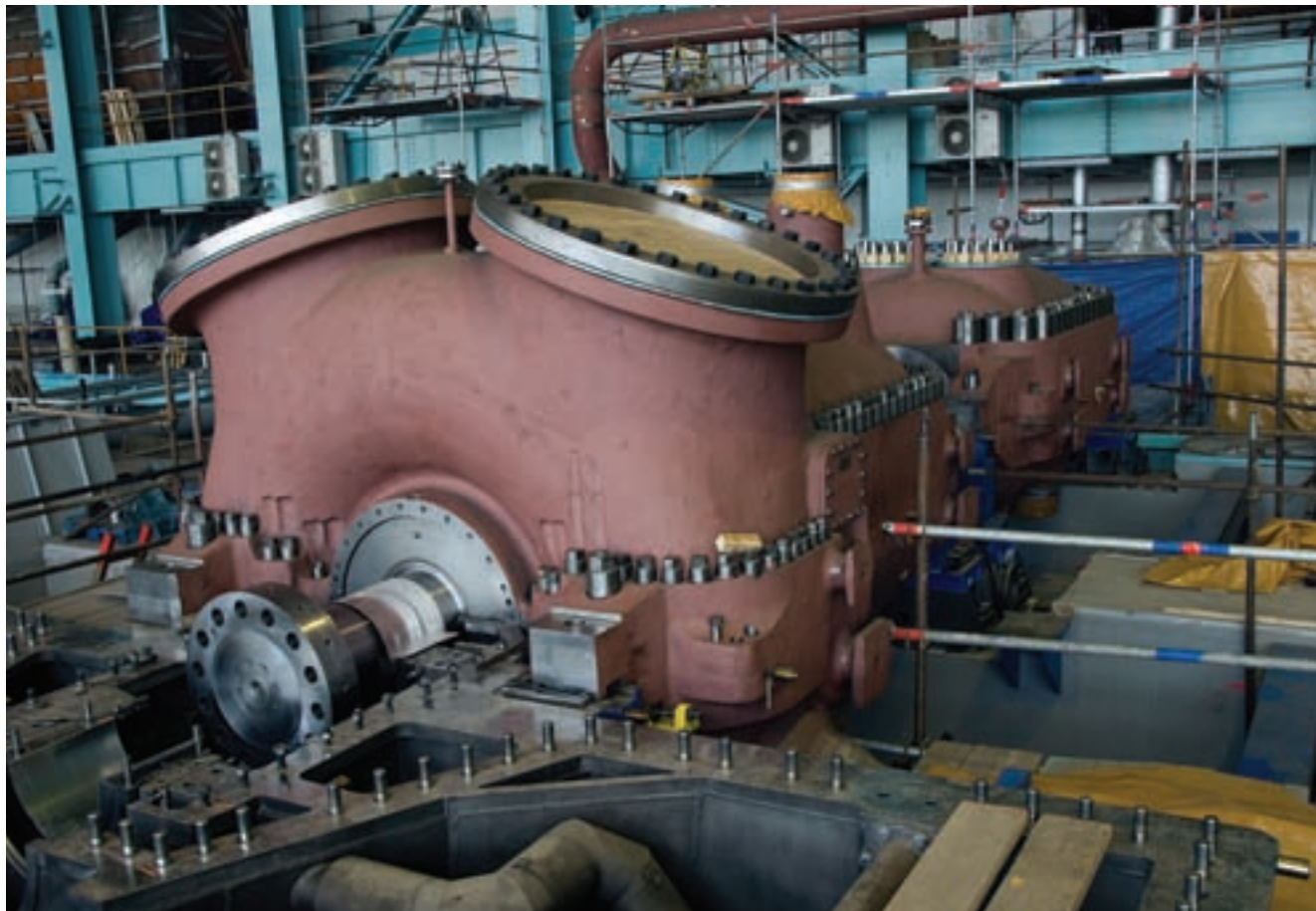
Středotlaký a vysokotlaký díl turbogenerátoru bloku 24
