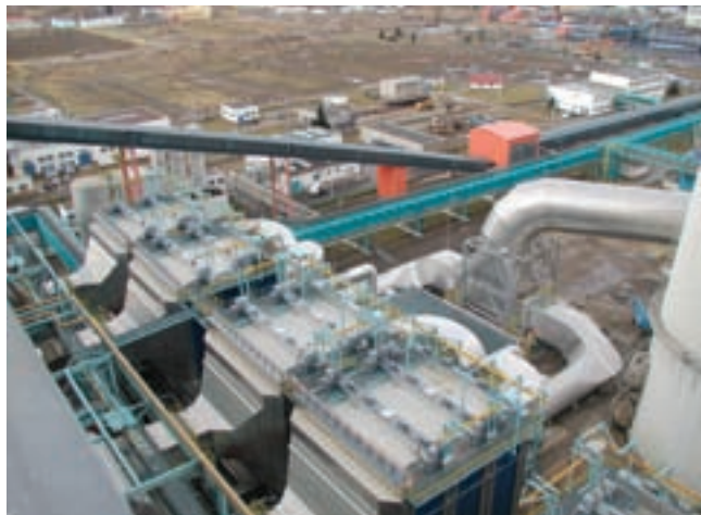
Pohled na provozní bloky 21 a 22 – odlučovače a spalínové ventilátory
