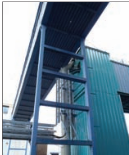
Provizorní kabelové trasy přeložené mimo kabelové kanály na mosty
