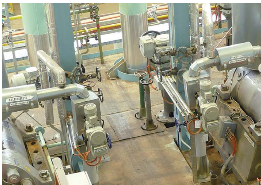
Blok A Elektrárny Tušimice II – strojovna
