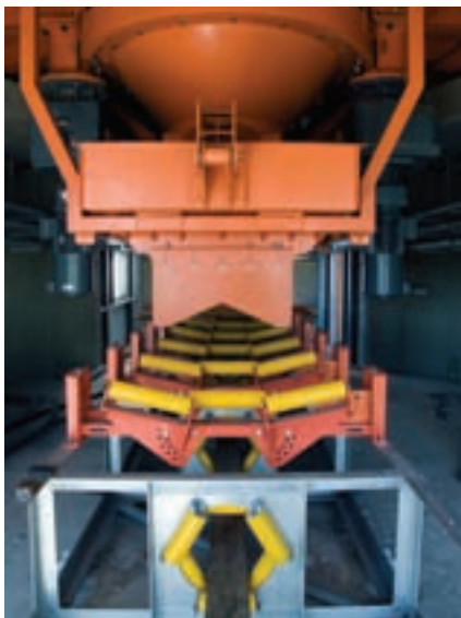
Výsypka pod rotačním vyhmovačem strusky
