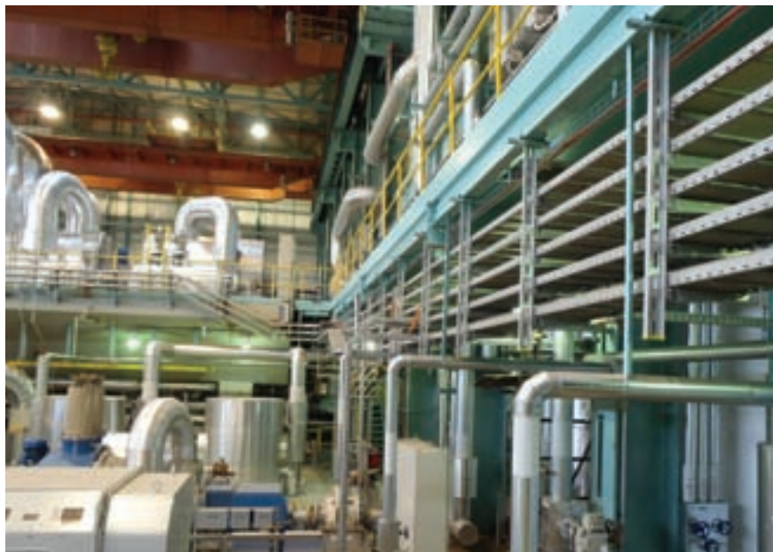
Kabelové trasy na strojovně
