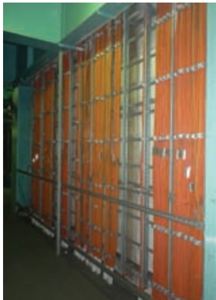
Technologické kabelové stoupačky - kotelna, 10,8 m
