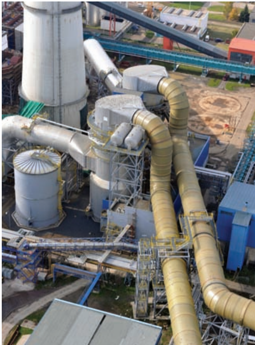
Pohled na odsíření - spalínovody a absorbéry
