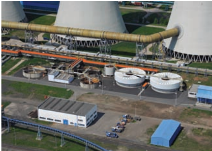
Zaústění kouřovodů čistých spalin do chladicích věží
