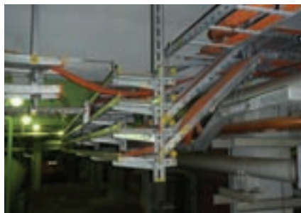
Kabelové trasy ve sklepních prostorách
