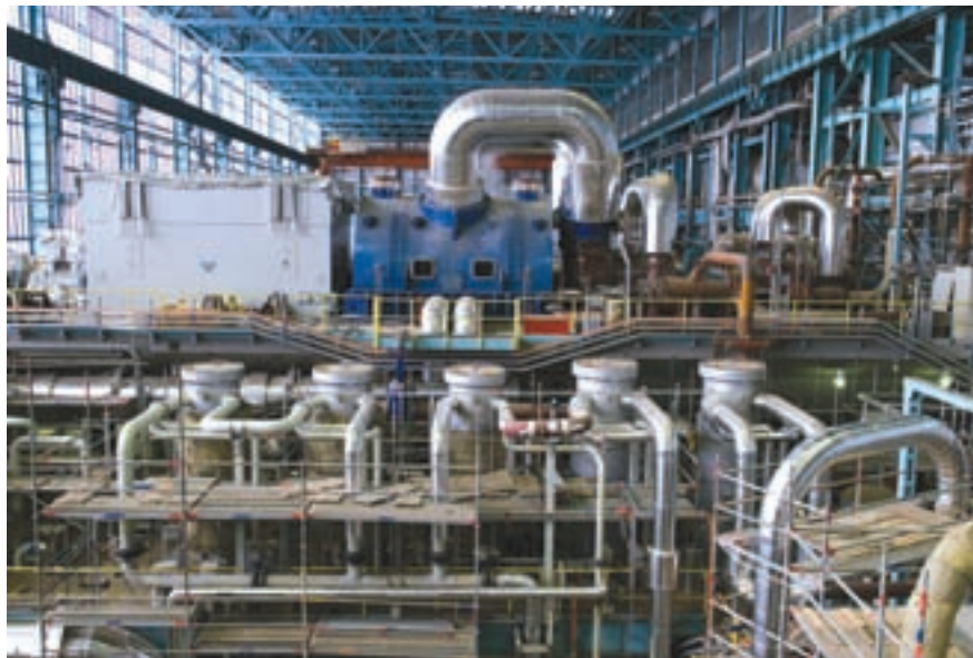
Pohled na turbogenerátor a vysokotlaké ohřívačky
