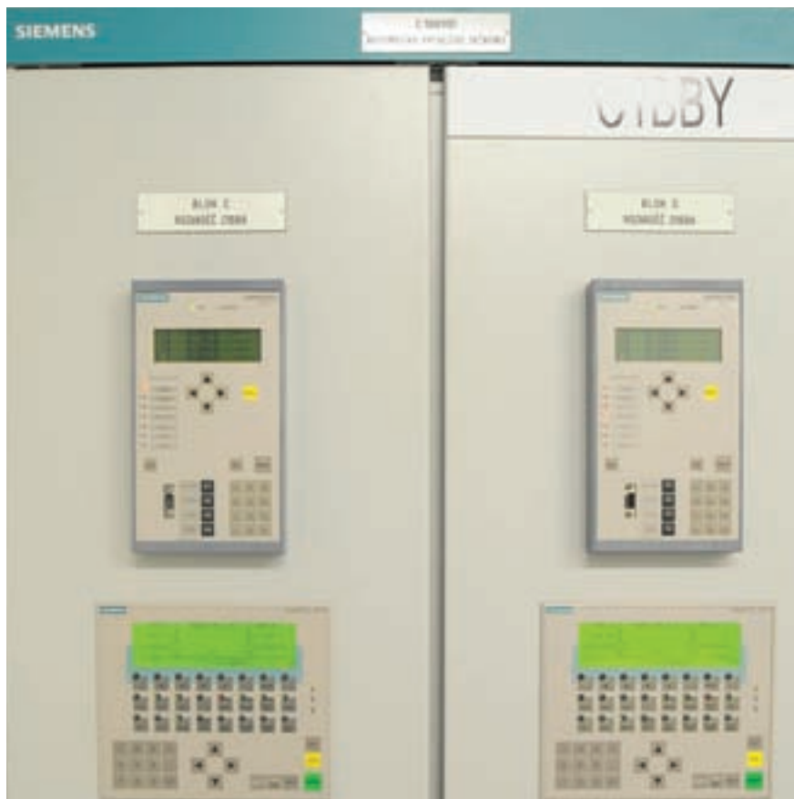
Skříň rychlého zásahu AUE Siemens v rozvodně C1BBA a C1BBB na bloku C
