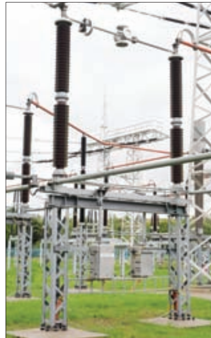
Rozvodna 400kV SIEMENS v rozvodně C1ACA na bloku C
