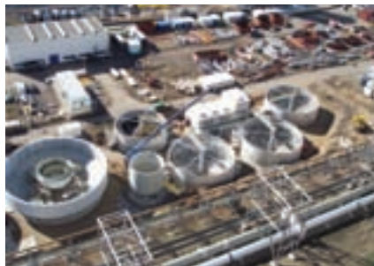
Pohled na osazenou technologii vodního hospodářství
