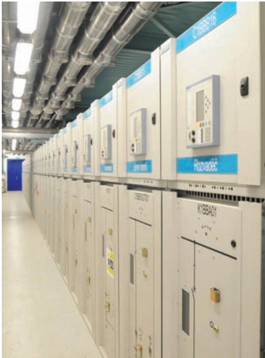
Rozvaděč VN Siemens v rozvodně C1BBA a C1BBB na bloku C
