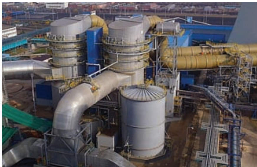
Pohled na technologický uzel zařízení na odsíření spalin
