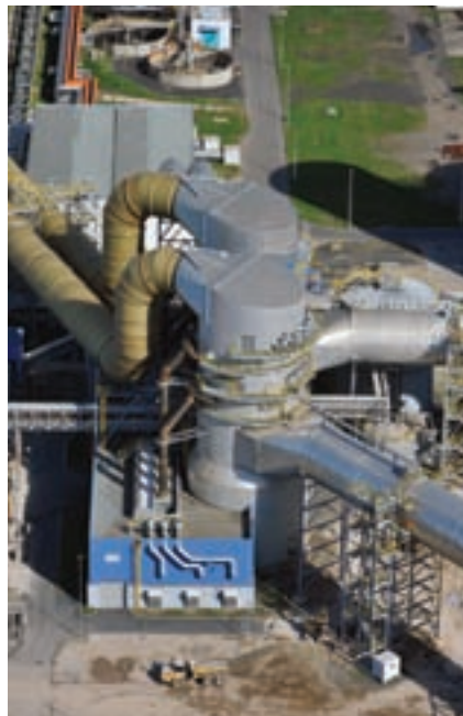
Pohled na odsíření - absorbéry a spalinovody
