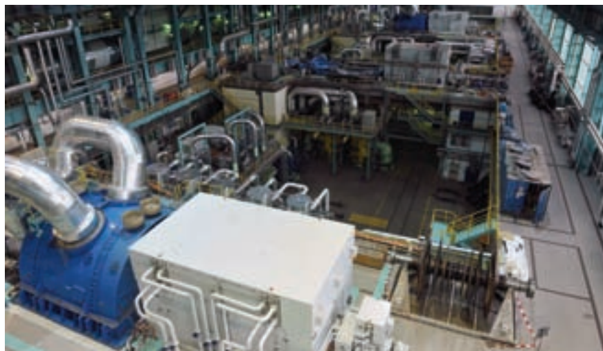
Celkový pohled strojovny
