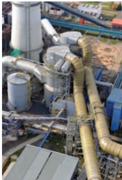
Ústí kouřovodu čistých plynů do absorbéru
