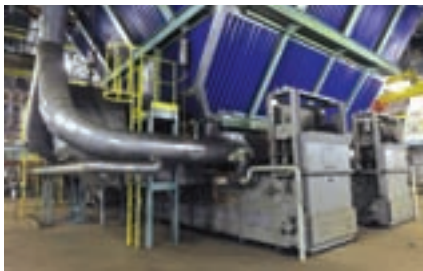
Pohled do interiéru kotelny
