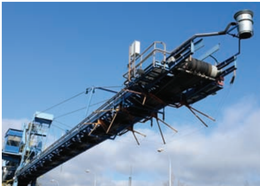
Mlžící zařízení na výložníku shazovacího vozu na skládce uhlí
