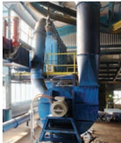
Pohled na odsávací zařízení pásů s ventilátorem
