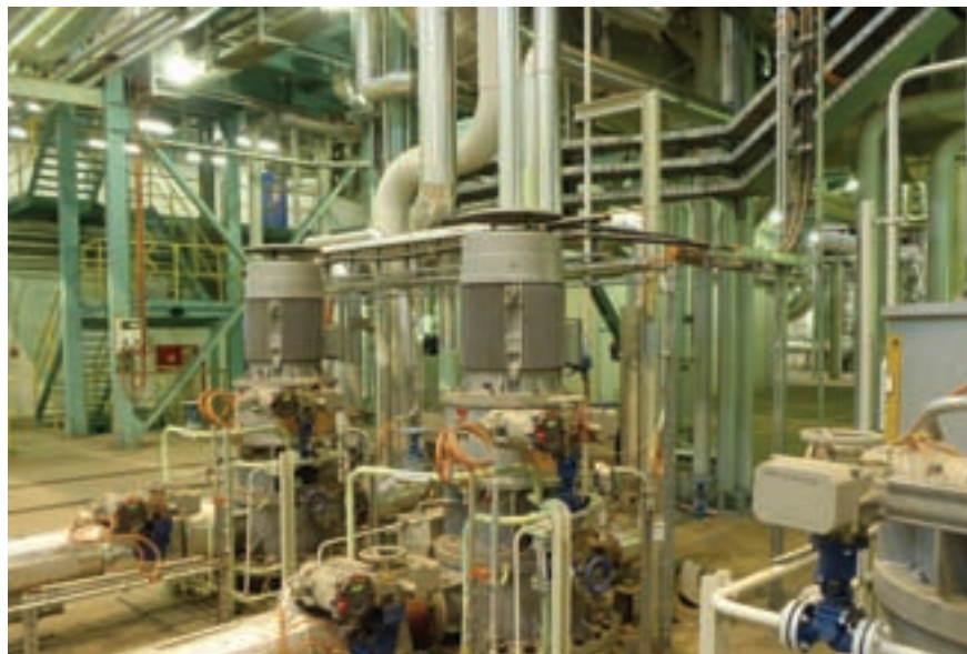
Připojení a elektrické pospojení servopohonů na strojovně
