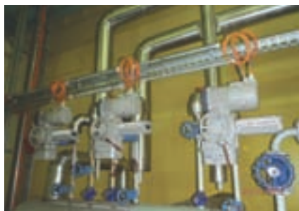
Připojení a elektrické pospojování pohonů na strojovně
