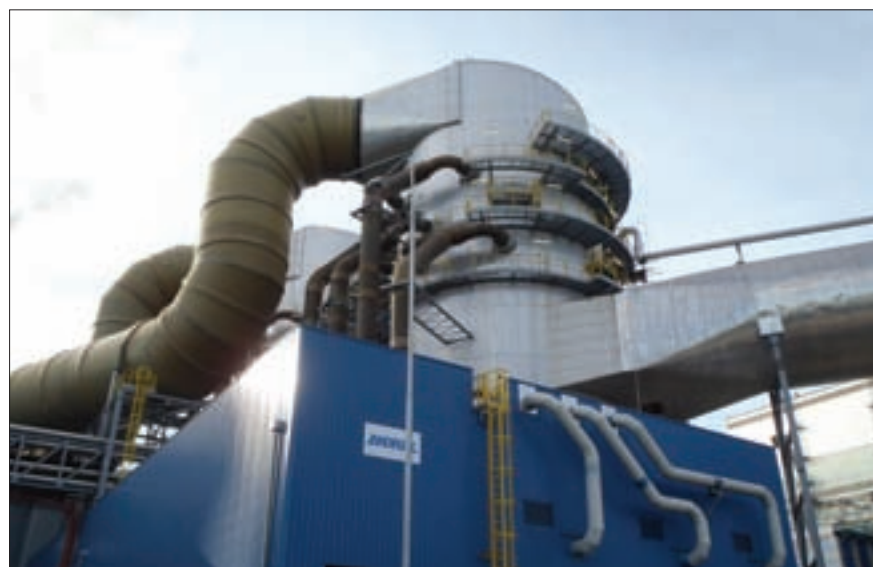
Osvětlení venkovních plošin na odsiřovací jednotce
