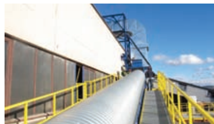
Pohled na dopravník biomasy
