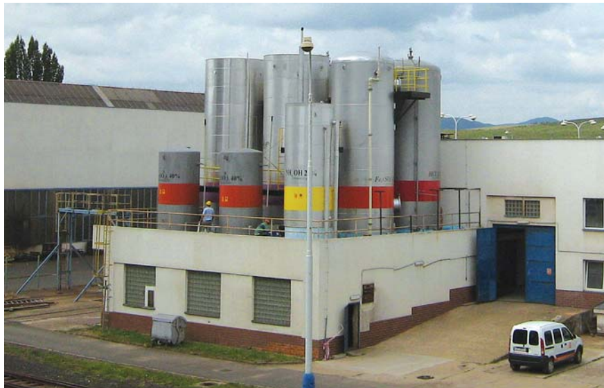
Chemická úprava vody
