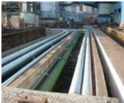
Kolektor - smontované potrubí v potrubním kolektoru
