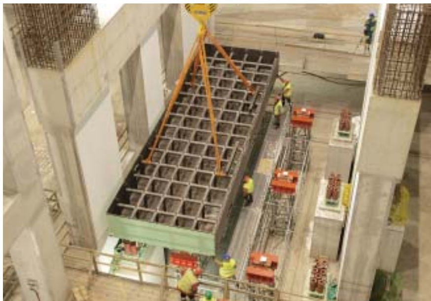
Snímek z usazování poloviny sběrače kondenzátoru na základ s pružinovými podpěrami a podpůrné věže
