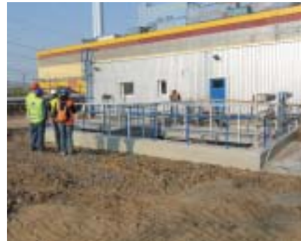
Snímek čerpací stanice dešťových vod
