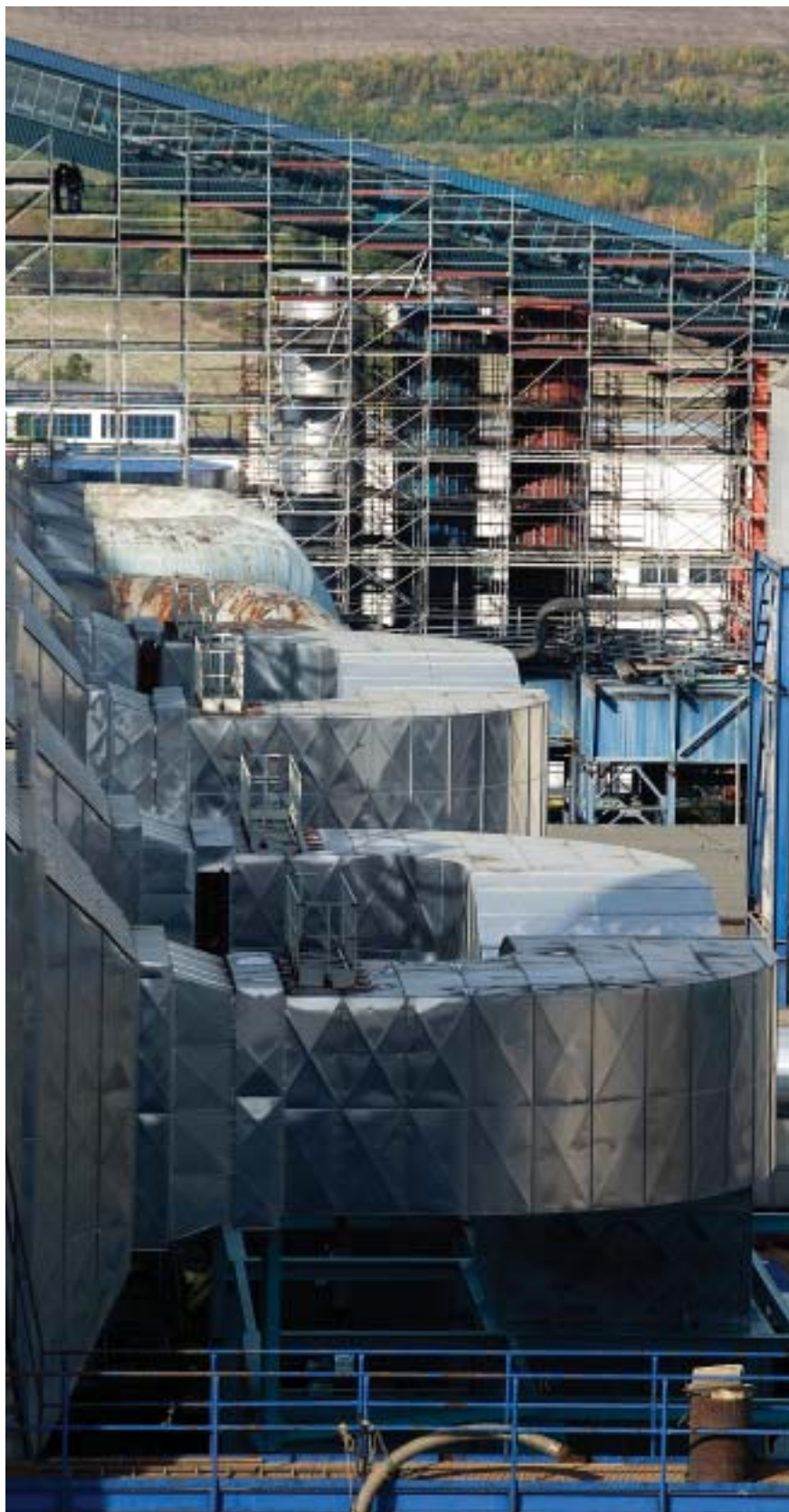
Kouřovody bloků 23 a 24 po komplexní obnově
