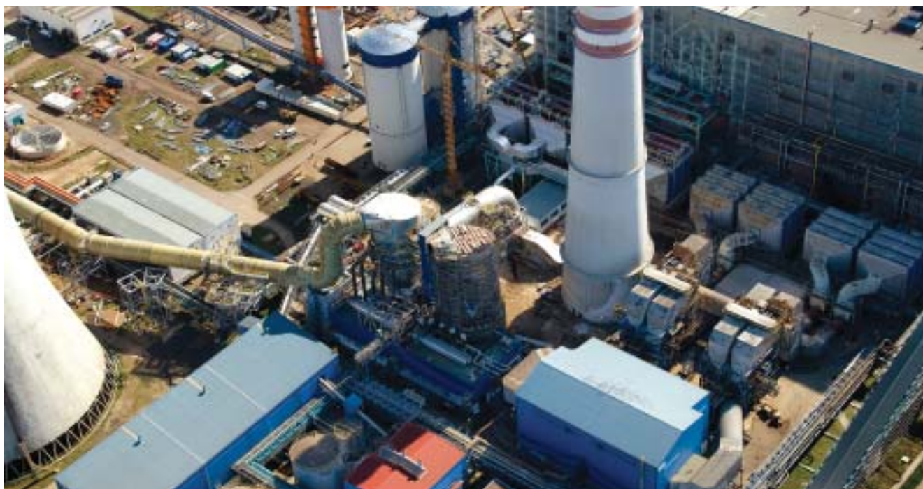
Technologická zařízení za kotelnou
