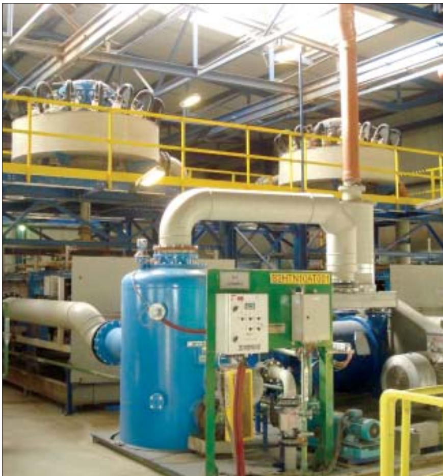
Odvodňovací linky energosádrovce v provozu
