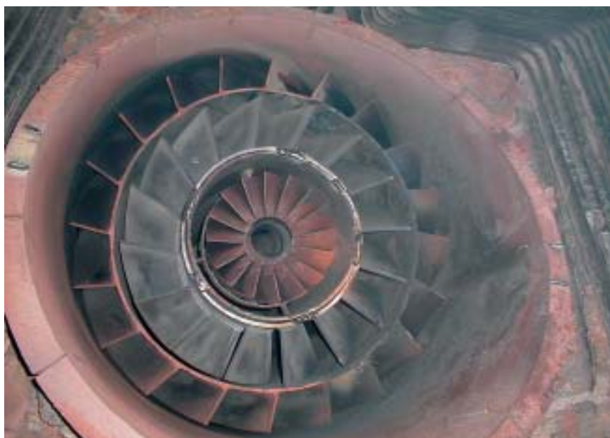
Pohled na práškový vřivý hořák s integrovaným plynovým hořákem
