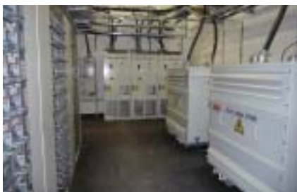
Frekvenční měniče a transformátory pro napájení kondenzačních čerpadel CHÚV
