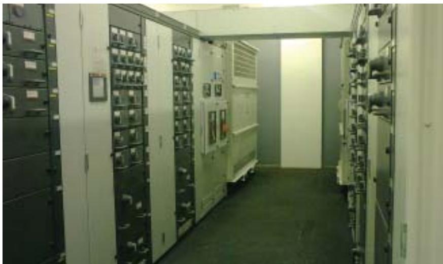
Rozvodna nízkého napětí na zauhlování
