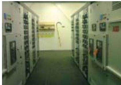
Rozvaděče MNS-iS v provozu zauhlování
