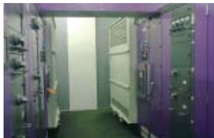
Rozvaděče a transformátory na zauhlování
