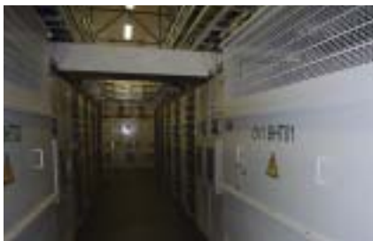
Rozvodna nízkého napětí pro CHÚV, transformátory a rozvaděče
