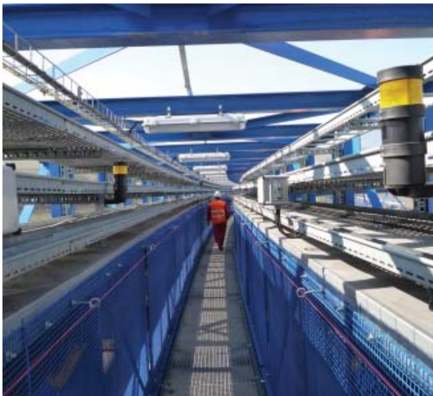
Kabelové trasy na zauhlovacím pase T6
