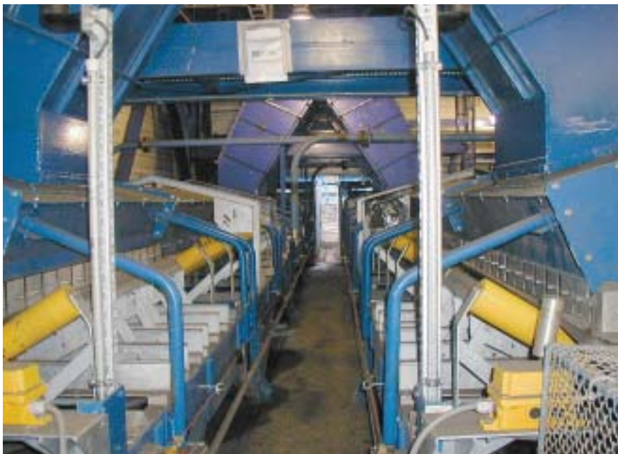
Dopravník T6 A/B: vratná stanice
