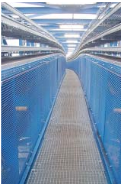
Dopravník T6 A/B: inspekční lávky
