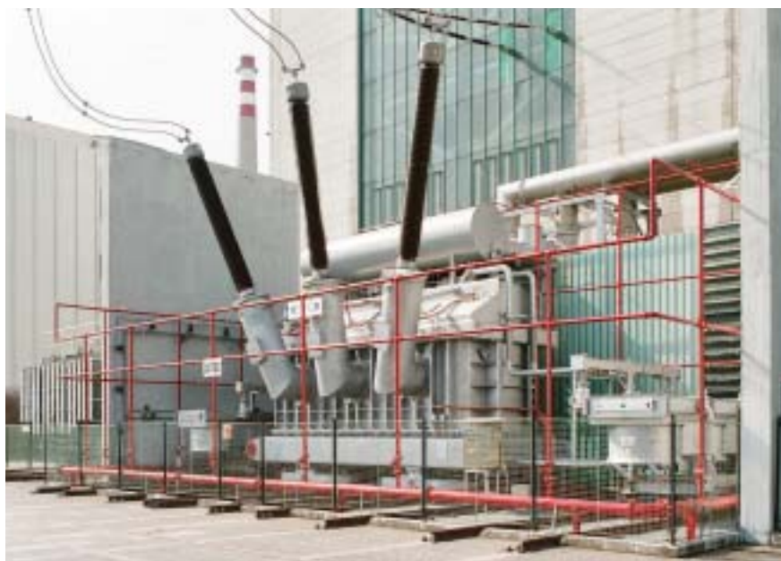
Nově instalovaný blokový transformátor 300 MVA
