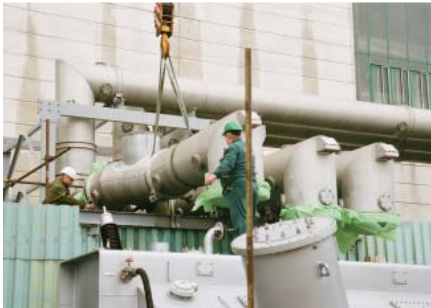
Montáž konců zapouzdřených vodičů k blokovému transformátoru
