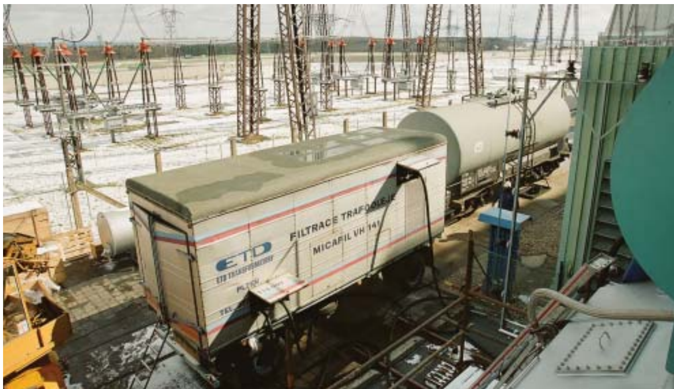
Filtrační stanice oleje napojená na nový blokový transformátor. Vpravo cisterna s olejem. Na pozadí zasněžená rozvodna vn 420kV
