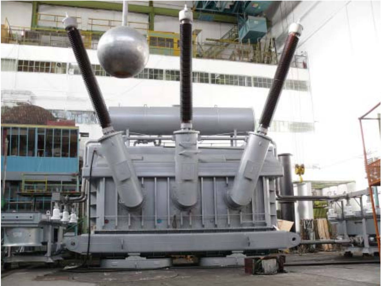
Tentýž transformátor po rekonstrukci (nyní již 300 MVA)
