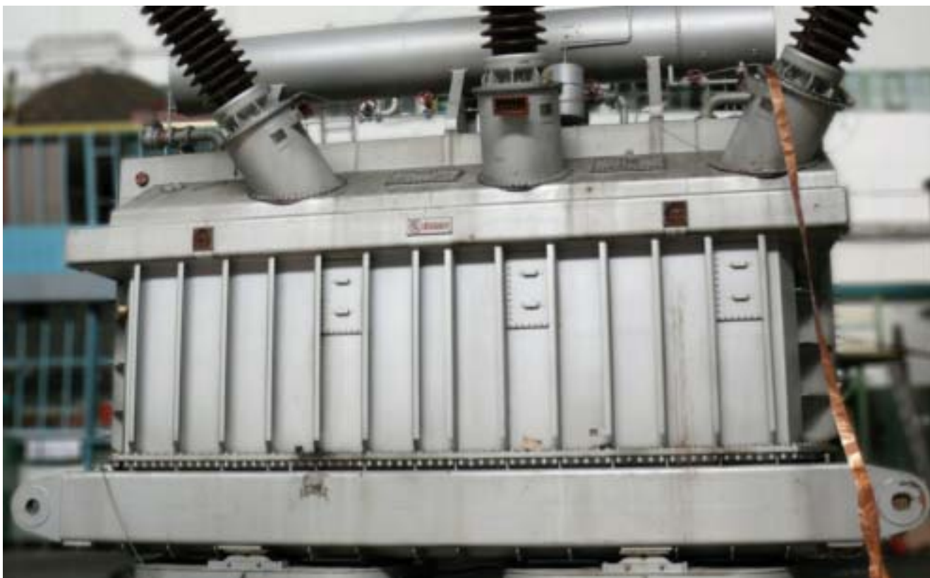
Transformátor 250 MVA před rekonstrukcí
