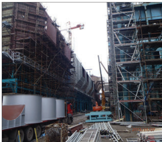
Obr. 14 – Odlučovače 23, 24 a 25, vstupní část (listopad 2013)
