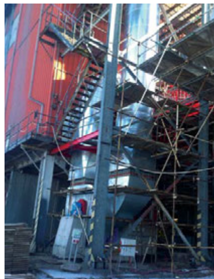
Obr. 9 – Spalinový ventilátor za kotlem K5 (29. 1. 2015)
