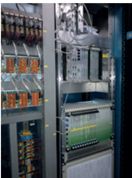
Elektrownia Opatowice – typowy przykład stopniowej migracji systemów sterujących kotła
