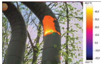
Na horkovodu je zvýšená povrchová teplota. Snímek je pořízen funkcí TwinPix, která spojuje reálný snímek a termogram
