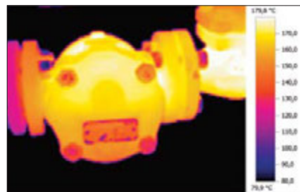
Špatně fungující odlučovač v rozvodu páry
