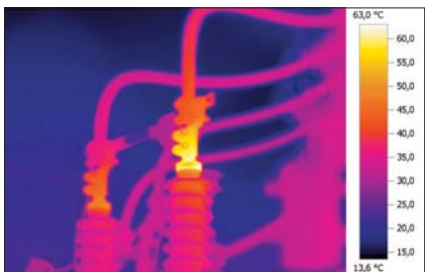
Reálný snímek a termogram na vysokém napětí. Pravděpodobně přechodový odpor způsobuje lokální zvýšení teploty elektrického spoje
