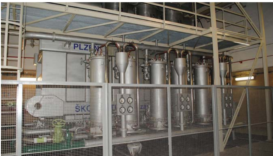
Tento transformátor byl jediným zařízením, které bylo do Dlouhých Strání přivezeno v celku
