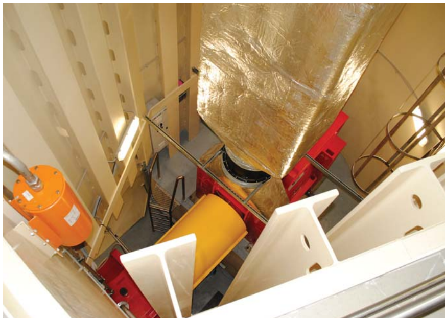
Technologická zařízení vodní elektrárny - generátor
