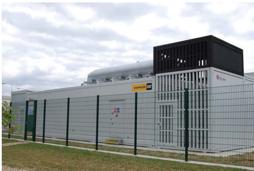
Pohled na nový dieselgenerátor SBO
