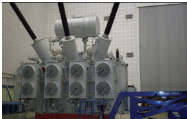
Obr. 6 – FAT Blokový transformátor
