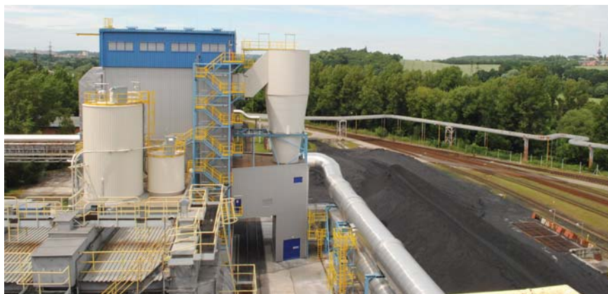
Snímek na již provozované odsíření kotlů K3 a K4
