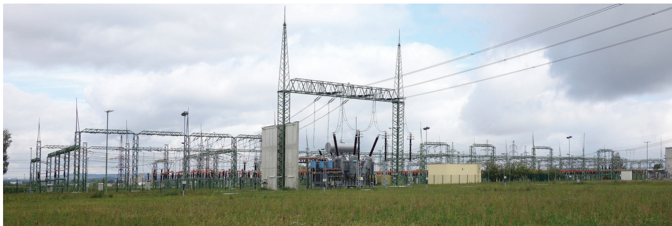
Pohled na stání s transformátorem T403
