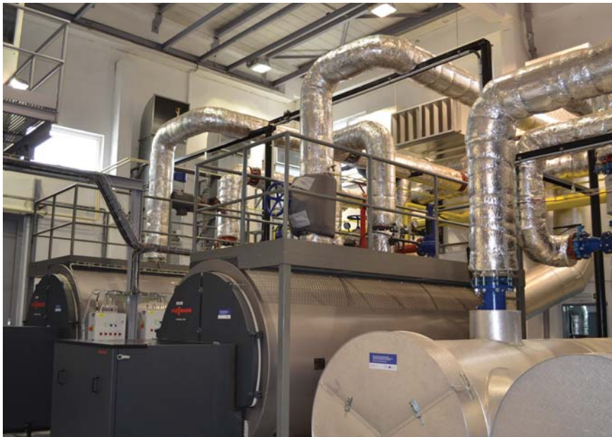
Kogenerační jednotka je moderním ekologickým zařízením, které dosahuje téměř 90% účinnosti ve využití primárního paliva - ilustrační foto
