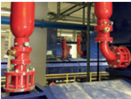
Fot. 3 - Instalacja systemu HRD do stłumienia wybuchu w zasobniku peletu, wraz z systemem izolacji wybuchu na wyjściu z zasobnika.
