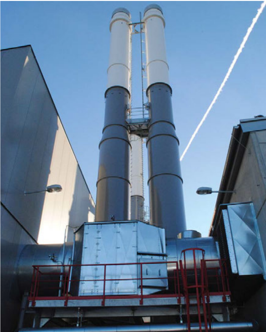
Vlevo budova plynových motorů, vpravo HRSG
