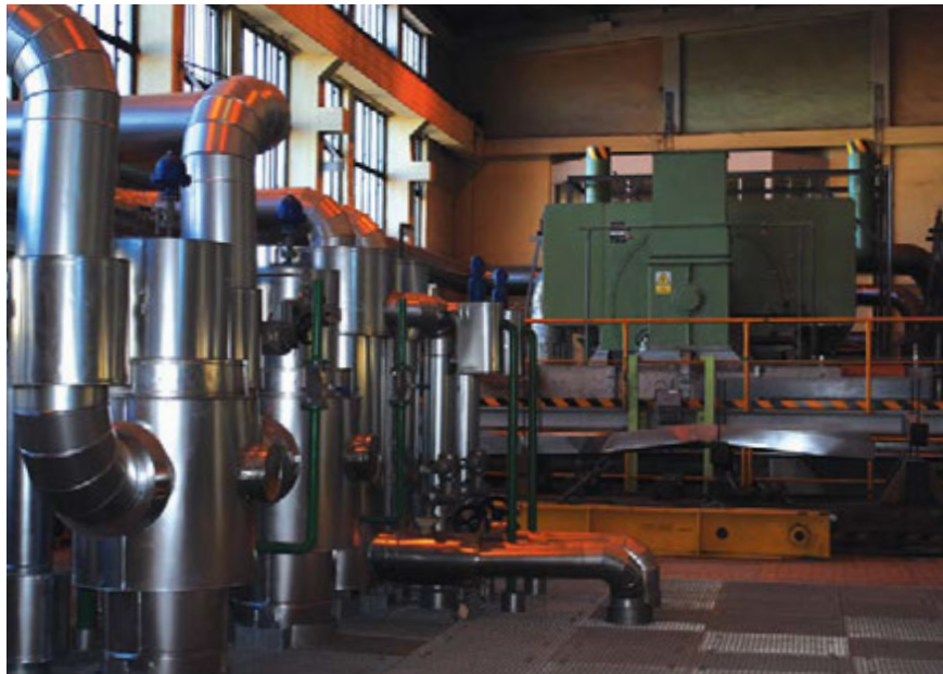
Výměníky tepla, vzadu turbogenerátor
