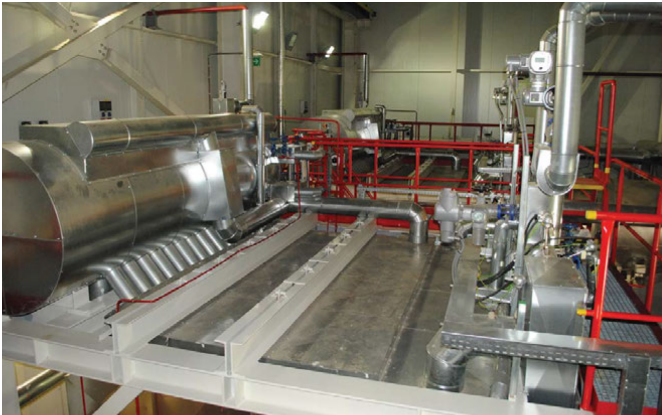
Pohled do budovy parogenerátorů HRSG
