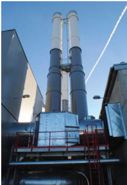
Pohled na část nového kogeneračního zdroje
