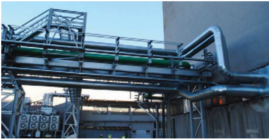
Přívod horké vody do výměňkové stanice
