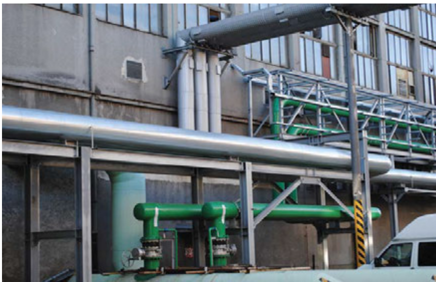
Potrubní rozvody médií
