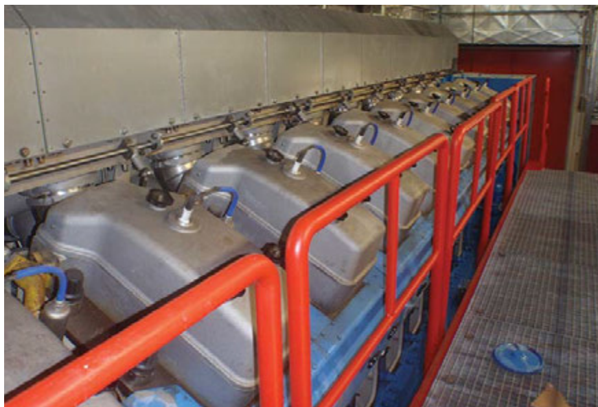
Pohled na plynový motor - vrchní část
