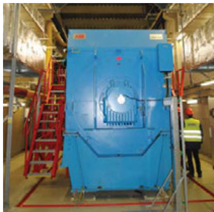
Jeden ze čtyř motorgenerátorů B35:40 instalovaných v teplárně Planá
