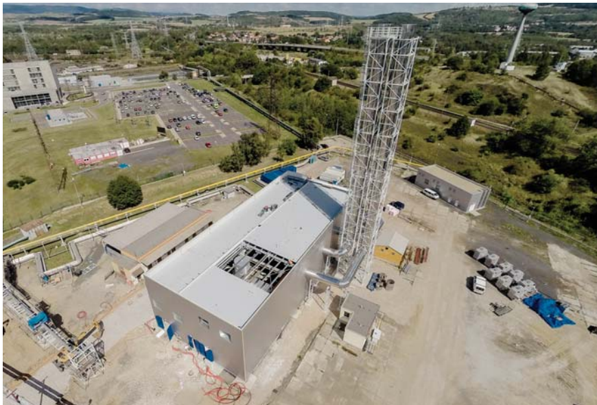
Pohled na novou kotelnu
