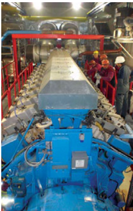
Plynový motor - pohled ve směru od generátoru
