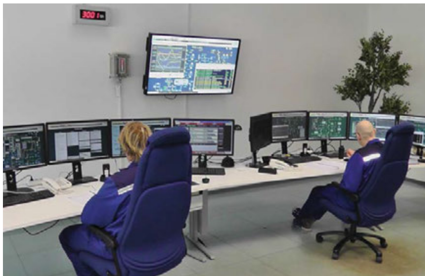
Velin nového bloku elektrárny
