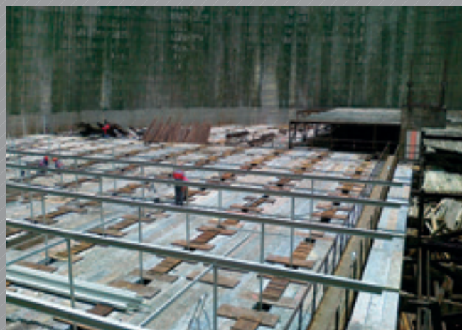
Jedna brygada zajmuje się rozbiórką starej konstrukcji (z tyłu), druga już zakłada nową - z kompozytu
