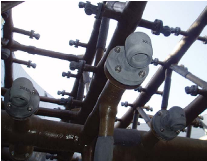
Sprchovací potrubí v absorběru – SprayHeaders
