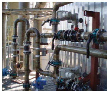
Sklolaminátové potrubí – Elektrárna Tušimice
