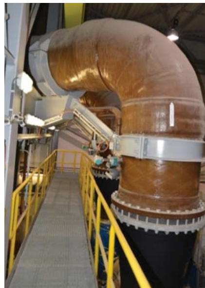
Sklolaminátové recirkulační potrubí – Elektrárna Pruněřov
