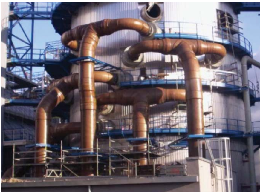
Sklolaminátové recirkulační potrubí – FGD Ledvice
