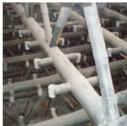
Sprchovací potrubí v absorběru – SprayHeaders
