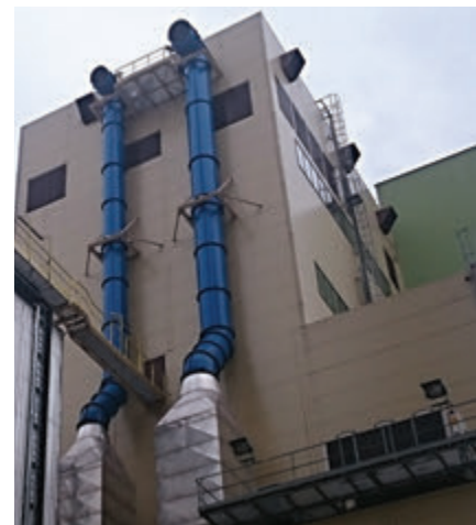
Sanie primárneho a sekundárneho vzduchu
