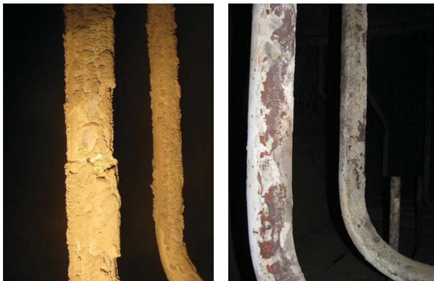
Obr. 4 – Porovnání zanesení trubek výparníku před a po odstávce a údržbě (říjen 2014)
