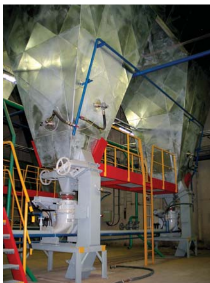
Řešení toku popílku ve výsypných částech výsypek elektrodudčovače (ČEZ, a.s., Elektrárna Mělník)
