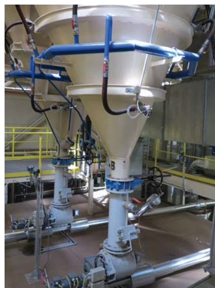
Řešení toku vápence v zásobním síle (Energetika Třinec)
