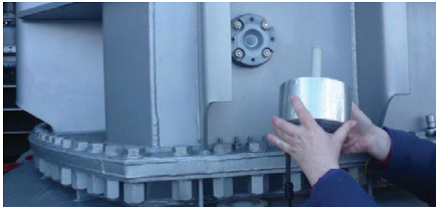
Obr. 1 – Snímací senzor a teflonové pouzdro v nádobě transformátoru
