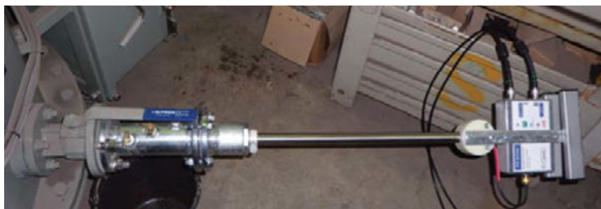
Obr. 2 – Snímací senzor zasunutý ve vypouštěcím ventilu nádoby transformátoru
