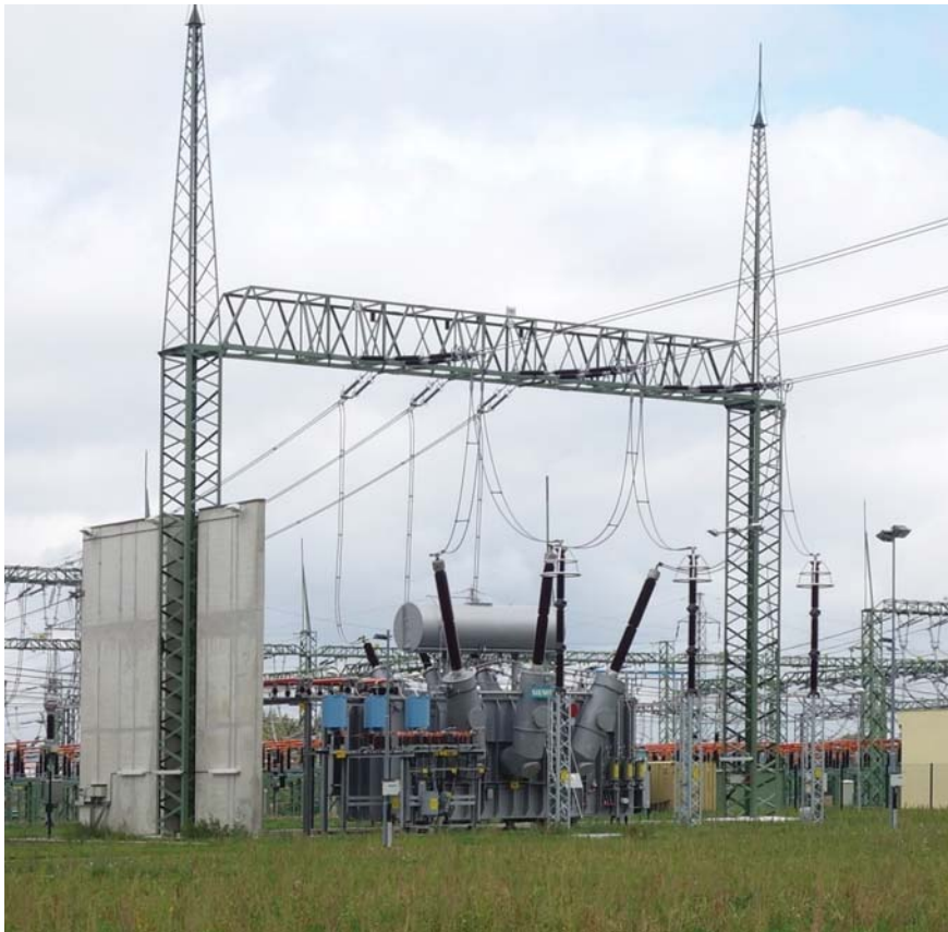
Transformátor v rozvodně Mírovka - ilustrační foto
