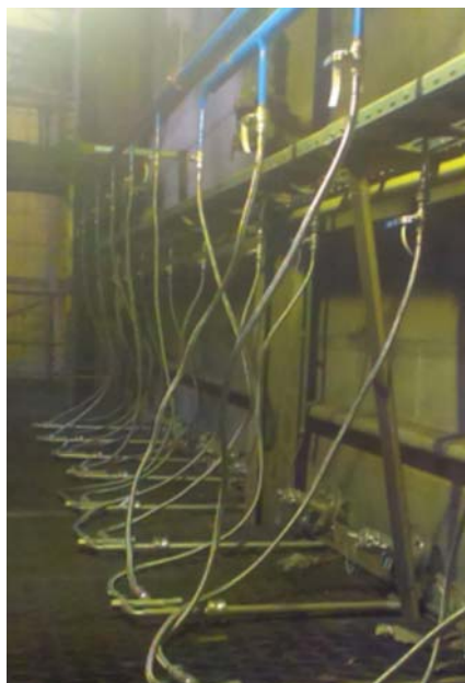
Obr. 16 – Vstřikovací kopí (Hladina 2, úroveň +28 m)
