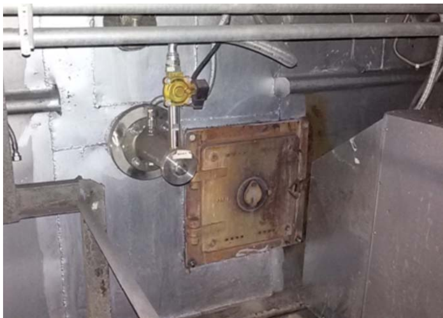
Obr. 17 – Vstřikovací kopí – Hladina 2 – úroveň +28m
