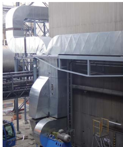
Obr. 7 - Potrubí recirkulovaných spalin (kotel K4)
