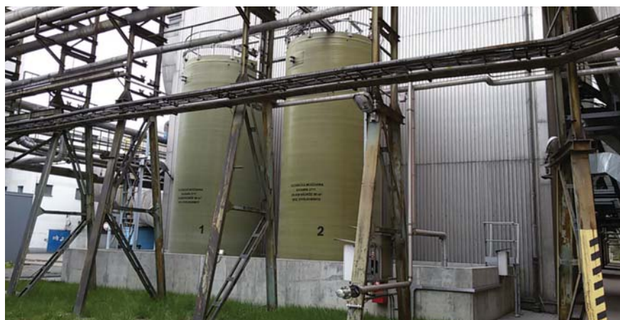
Obr. 14 – Skladování reagentu umístěného na úrovni +0 vedle budovy elektro odlučovače popílku kotle K6
