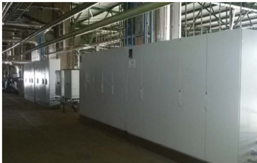
Obr. 15 – Směšovací a rozdělovací modul + řídicí jednotka AGAM (pro kotle K1 a K2) ve strojovně (+18 m)
