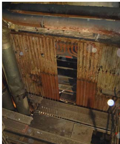
Obr. 4 - Pohled na modifikované hořákové okno pro nové hořáky (kotel K4)
