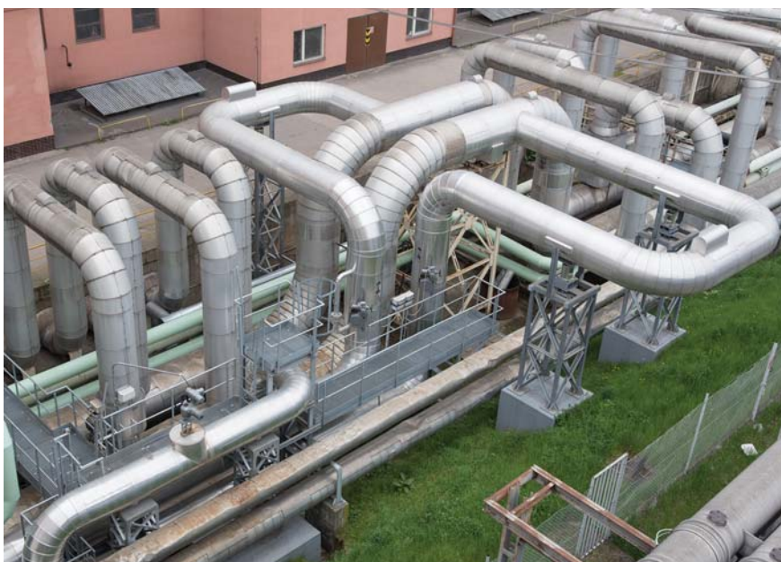
Potrubi zásobování teplem měst Praha a Neratovice, včetně potrubí vstupů a výstupů k ohřívákům turbogenerátorů.
