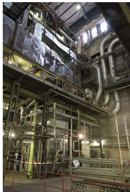
Pohled na kotelnu na kótě +15 m - boční pohled na jeden z kotlů v místě spalovací komory. Patrné jsou vzduchové kanály (primární vzduchy).
