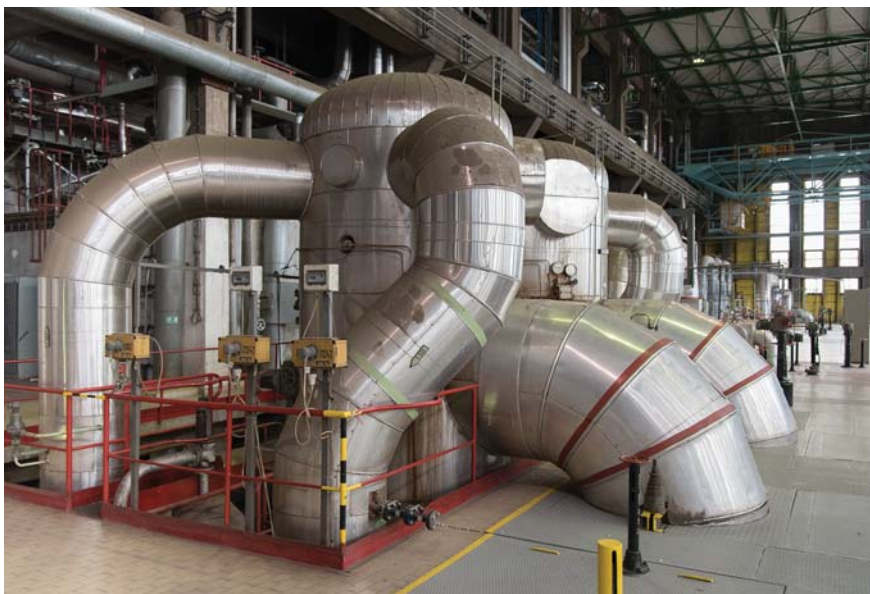
Špičkový ohřívák TG3. Výstupní pára z vysokotlakého turbogenerátoru slouží pro potřeby systému centrálního zásobování teplem Mělník - Praha
