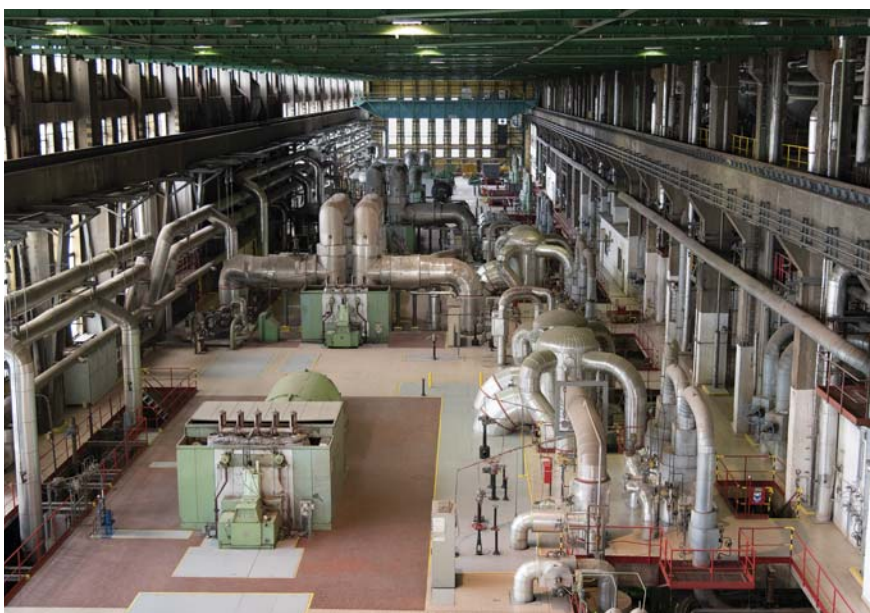
Teplárna Mělník - pohled na strojovnu. V popředí je vidět protitlaká parní turbína a v pozadí odběrová parní turbína
