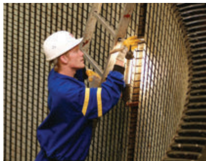
Plán modernizací soustrojí je průběžně schvalován a revidován podle stavu provozů a očekávaných potřeb české energetiky
