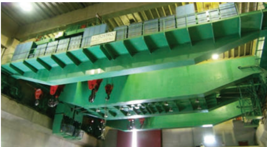
V roce 2016 proběhne rekonstrukce 2 x 300 tunových mostových jeřábů ve vodní elektrárně Tarbela (Pákistán)
