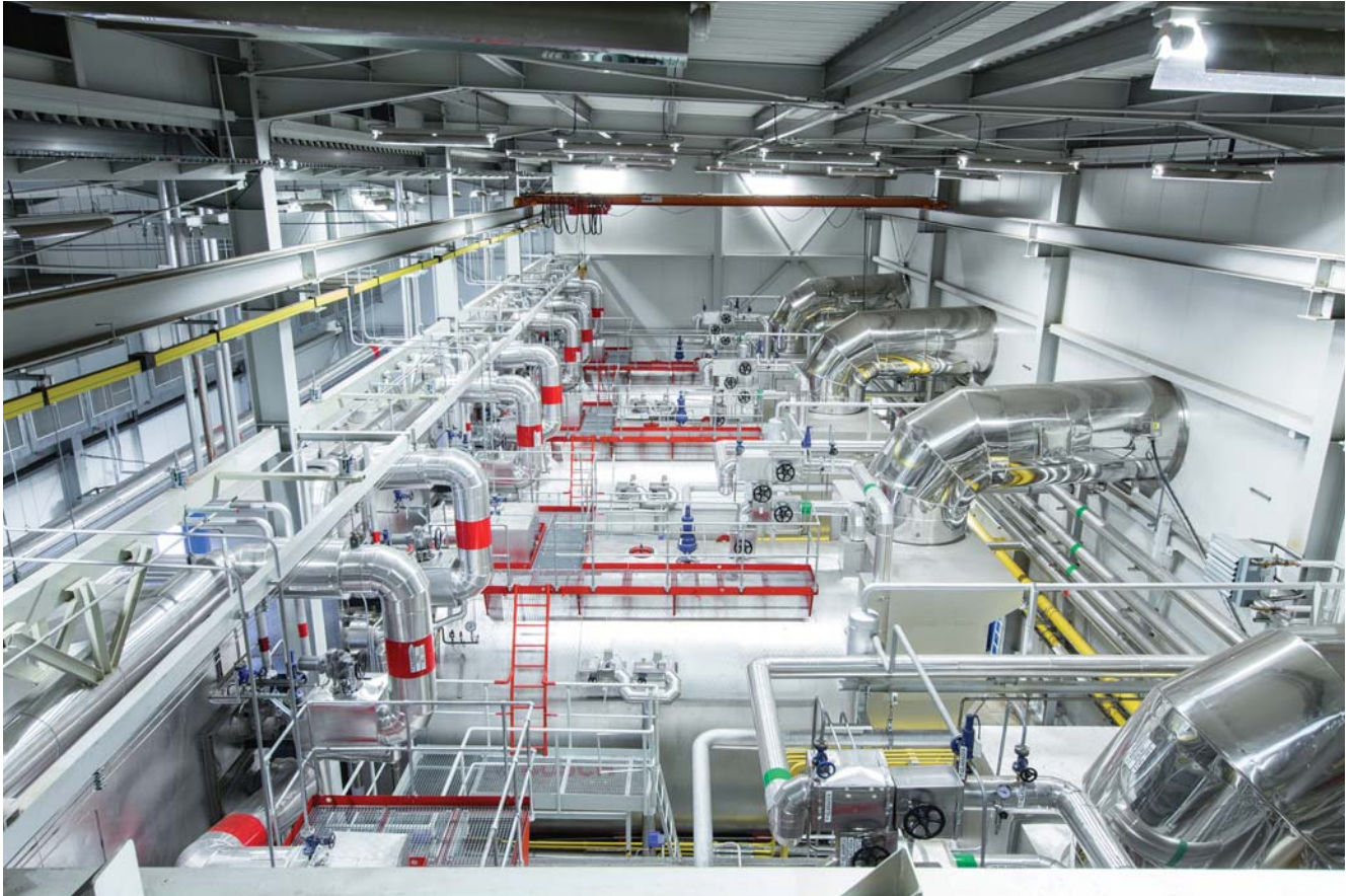
Pohled na zařízení plynové kotelny
