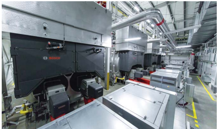
Pohled na kotle
