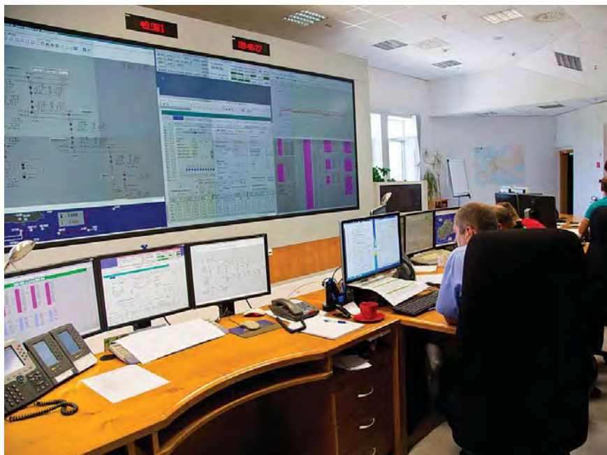
Správce slovenské prenosové soustavy chystá modernizaci svého centrálního dispečinku
