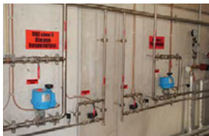
Obr. 6 – Ventily v místě olejového hospodářství
