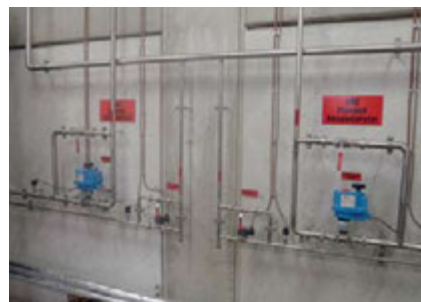
Obr. 4 – Sestava sekčních ventilů ve strojvně
