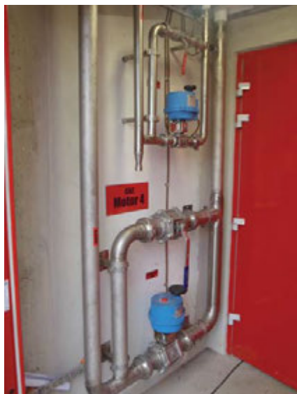
Obr. 7 – Sekční ventily místnosti plynového motoru
